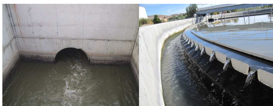
Figura 10.-Vista de la entrada y salida del agua en una planta depuradora de aguas urbanas.
