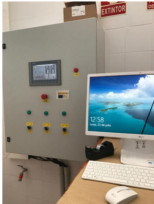
Figura 4. Cuadro de control y ordenador para la modificación de la configuración de control del banco
