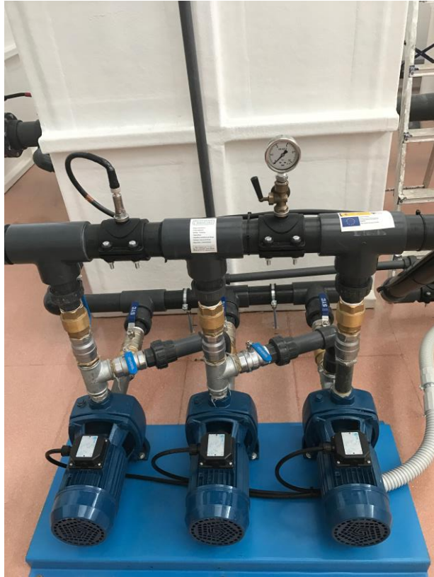
Figura 1. Bancada con tres bombas de 1.5 kW, 2 kW y 2.5 kW
