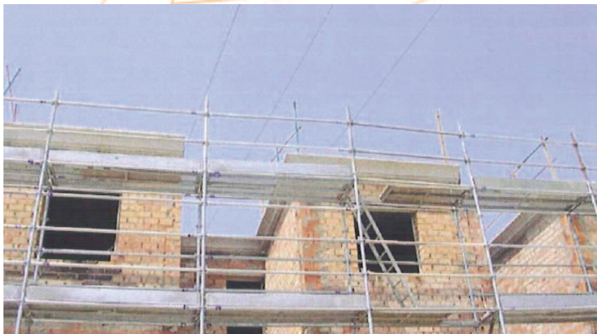
Imagen 2. Construcción de viviendas bajo línea aérea eléctrica de alta tensión.
