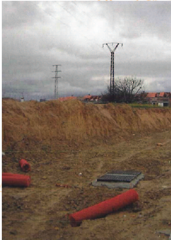
Imagen 5. Obra civil para el soterramiento de la línea eléctrica de alta tensión
